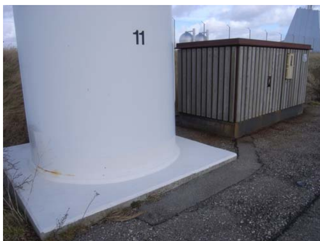
Figur 10. Fundament og anlæg ved vindmølle.
